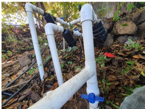
Figura 10: Tubulação do sistema de irrigação
