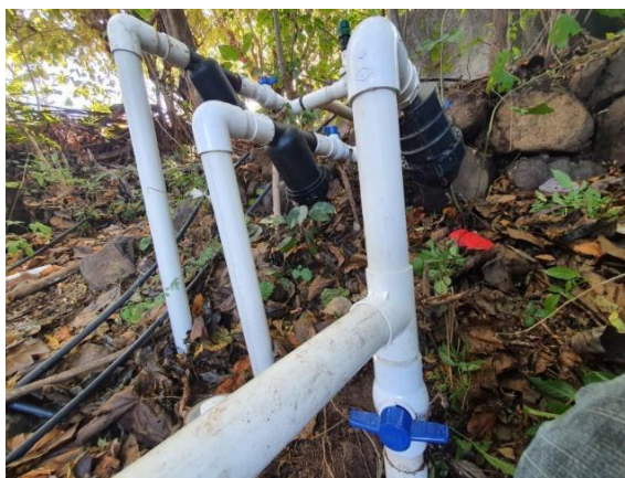
Figura 10: Tubería del sistema de riego
